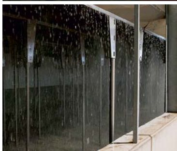
Oczyszczaniem zużytego powietrza
